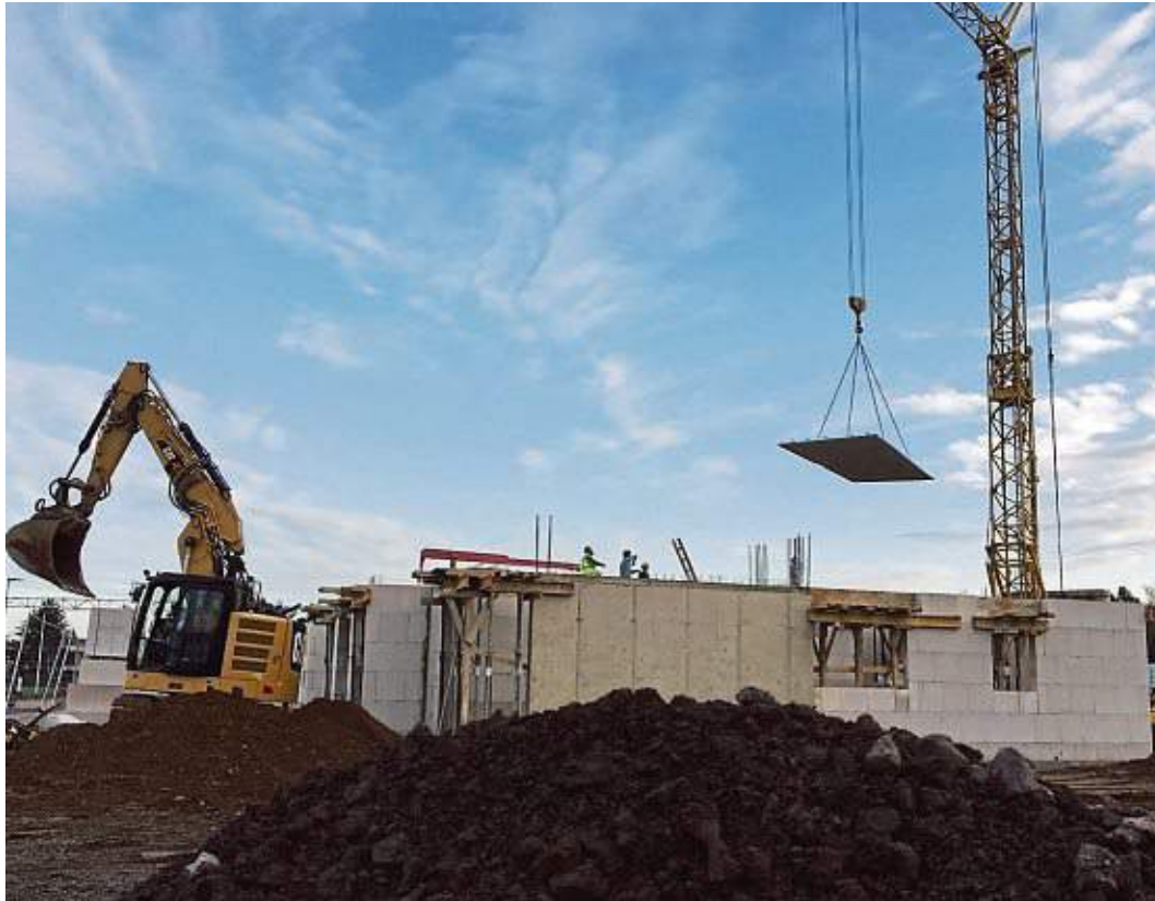
Am nordwestlichen Ortsrand von Schwadorf wird in den kommenden Jahren eifrig gebaut. Einen Großteil der Arbeiten stemmt das Brühler Unternehmen Yanmaz Immobilienbau. Fotos: Kämpf
